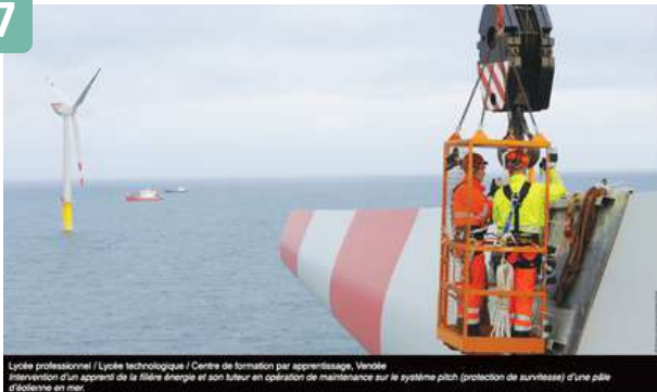
Lycée professionnel / Lycée technologique / Centre de formation par apprentissage, Vendée Intervention d'un apprenti de la filière énergie et son tuteur en opération de maintenance sur le système pitch (protection de survitesse) d'une pile d'éolienne en mer.
