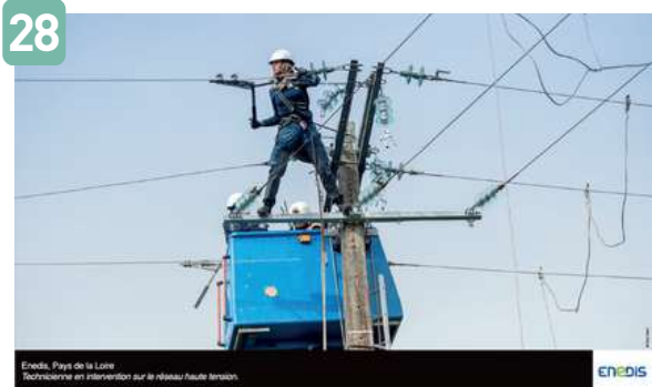
28 Enedis, Pays de la Loire Technicienne en intervention sur le réseau haute tension.
